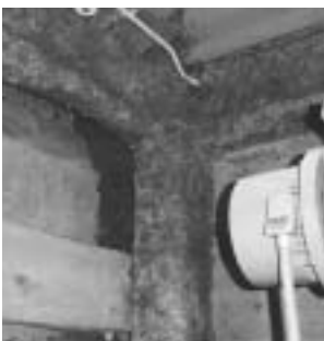
アスベストが使用されている施設の一部
