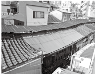
▲銅座市場の崩落現場
