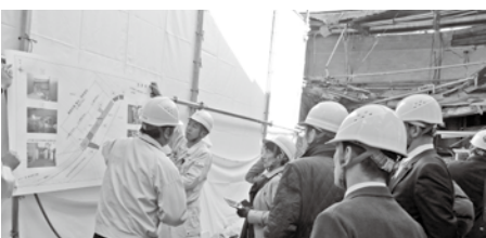
▲銅座市場崩落後の状況を調査
