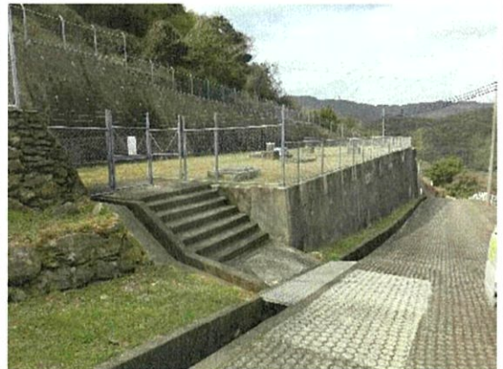
本河内高部減圧槽現況写真
