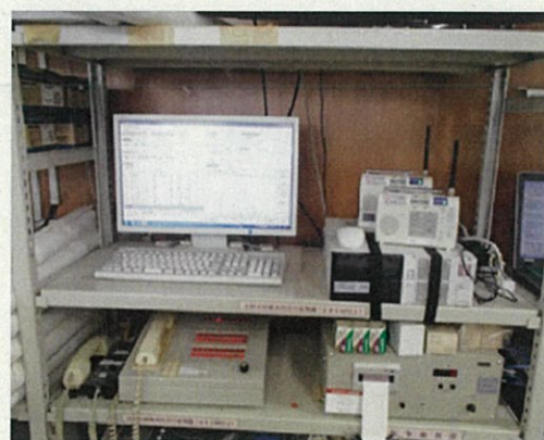
主配信局 1箇所 副配信局 8箇所
