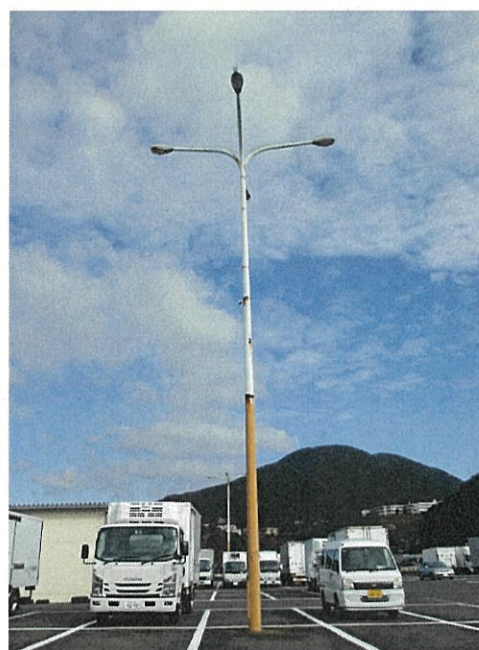
照明ポール高さ 12m
