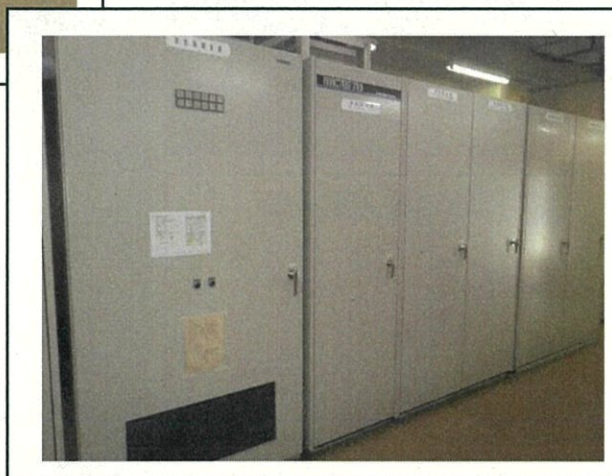
コントローラ (汚泥処理棟電気室)
