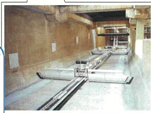
汚泥掻寄機 (最終沈殿池)
