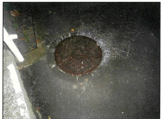
流下不良による汚水の溢水状況
