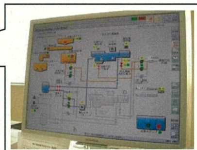
監視制御装置画面 (イメージ)
