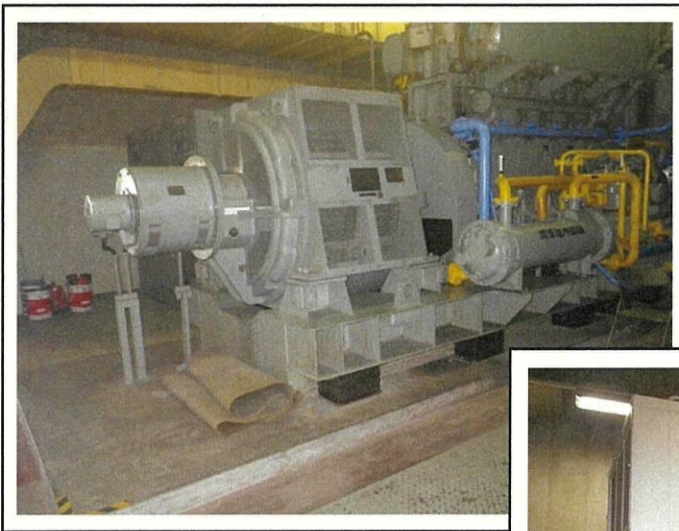
既設自家発電設備
