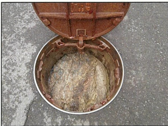
流下不良による汚水の滞留状況
