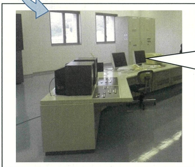
監視制御装置（監視室）
