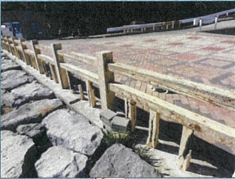
④防護柵老朽化状況
