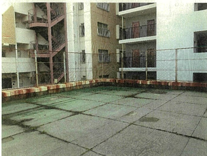
<屋上 防水シートの劣化>
