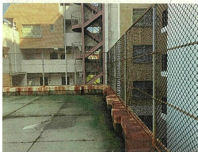
<屋上 防水シートの剥がれ>
