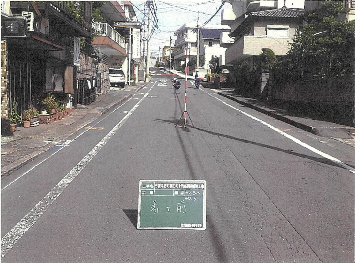
子供を守るネットワークの通学路点検に伴う速度抑制(ハンプ設置)
