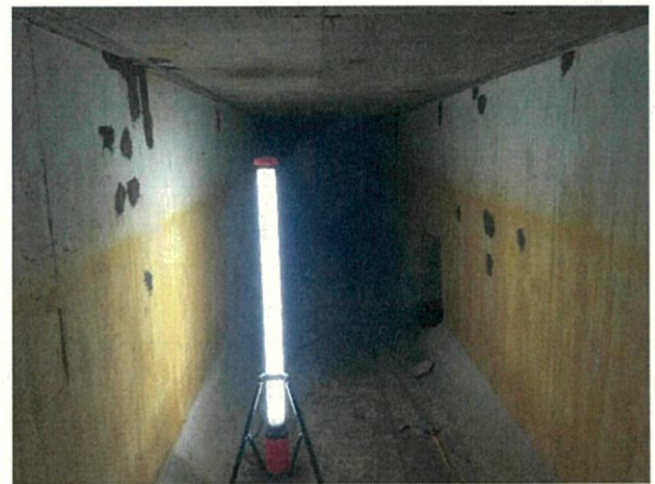
鉄筋の腐食 (④ 浄水渠)
