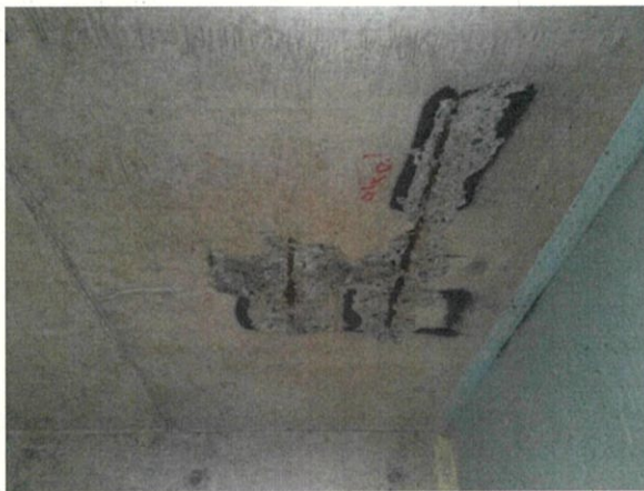
鉄筋の腐食 (③ 原水渠)
