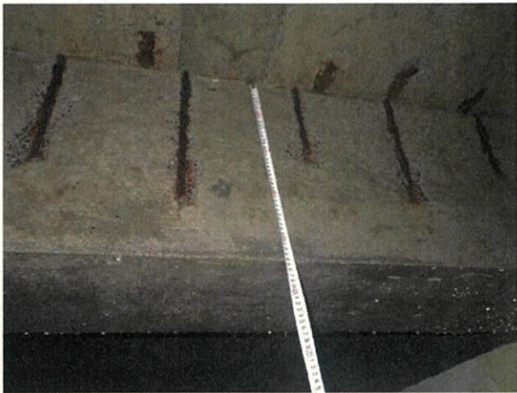
鉄筋の腐食 (① ろ過池 配管廊)
