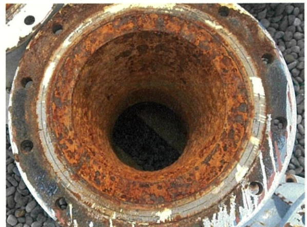
流量計の劣化 (⑤ 流量計 (ベンチュリー管))
