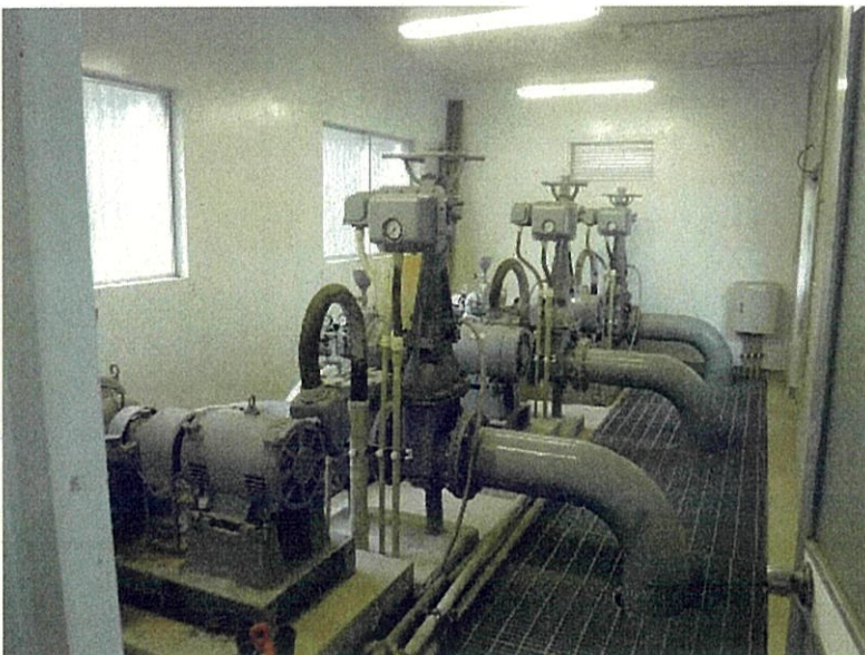
ポンプ状況写真
