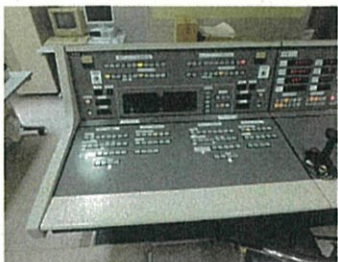
テレメータ放流設備
