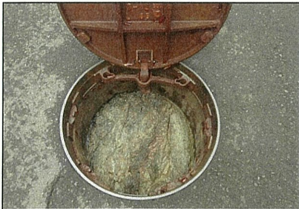
流下不良による污水の滞留状況
