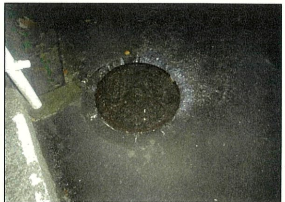
流下不良による污水の溢水状況
