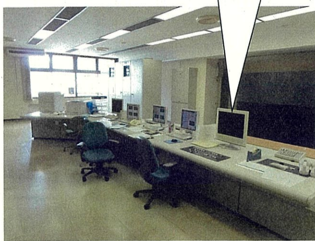
監視制御装置 (管理棟監視室) 状況写真
