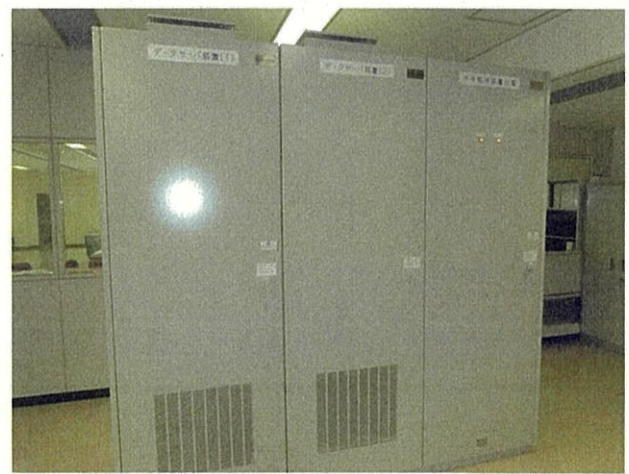
データサーバ装置 (管理棟) 状況写真
