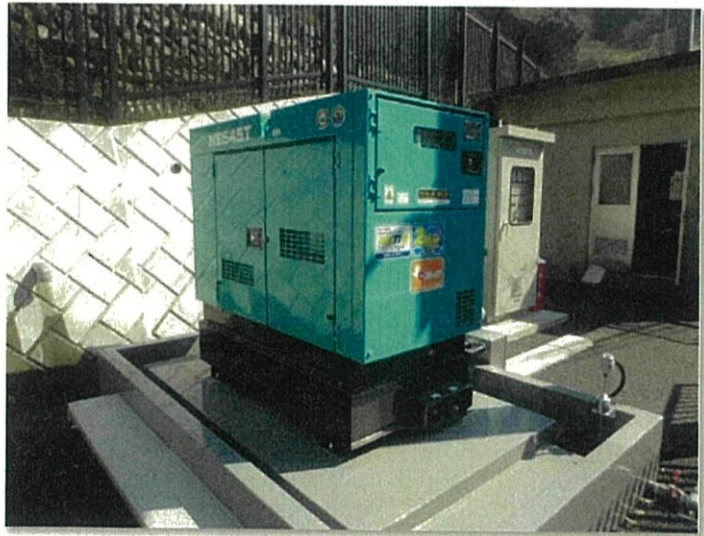
自家発電設備設置イメージ写真
