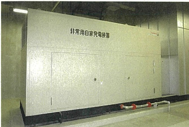
自家発電設備更新イメージ写真
