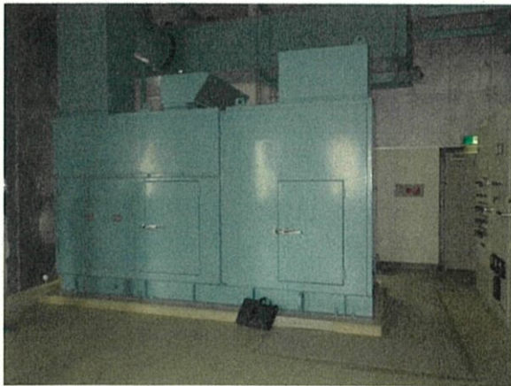
自家発電設備状況写真
