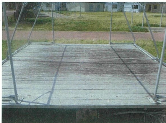
② (テント台座) 浮き等劣化
