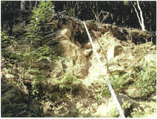
崩壊部分の亀裂や地質、地形の確認状況
