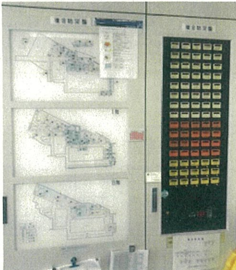
【自動火災報知設備(受信機)】
