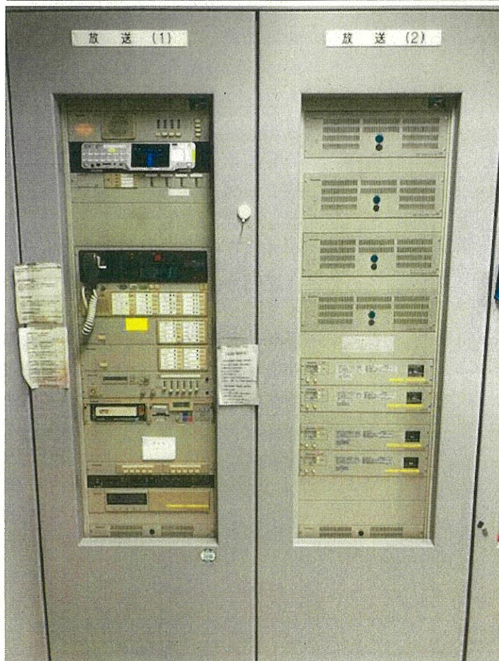
非常用放送設備（中央監視室内）
