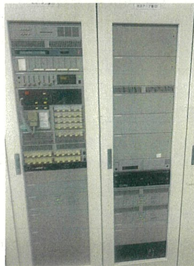
【防災アンプ盤】
