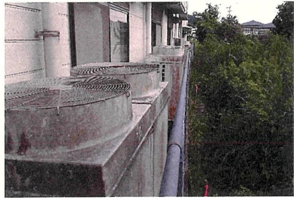
【既存空調設備(室外機)】
