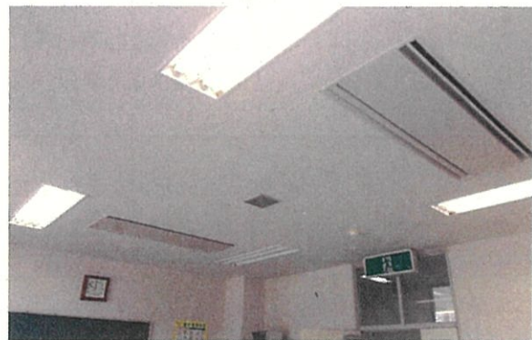
【既存空調設備(室内)】
