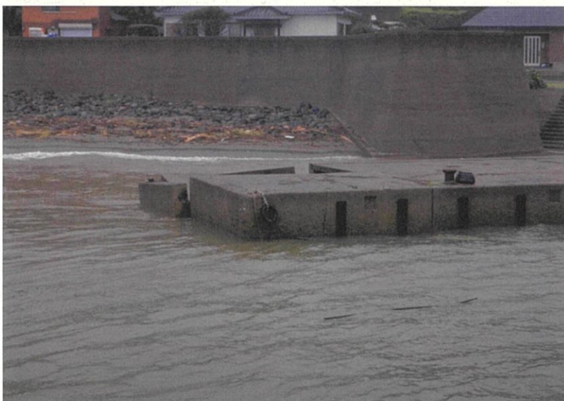
物揚場崩壊状況 （逆方向）
