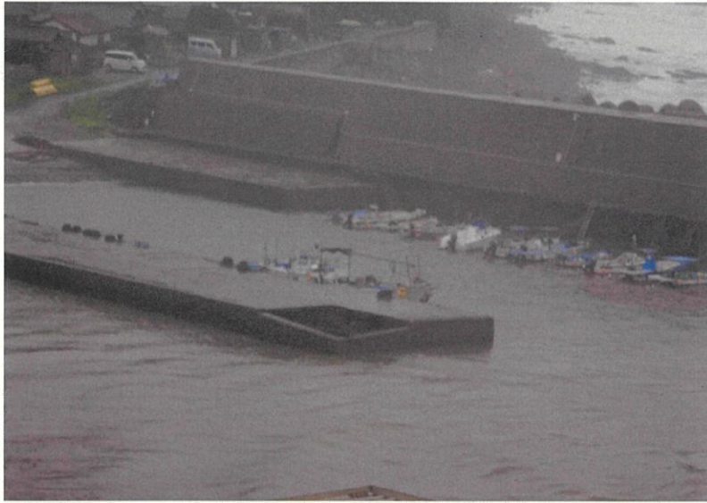
物揚場崩壊状況
