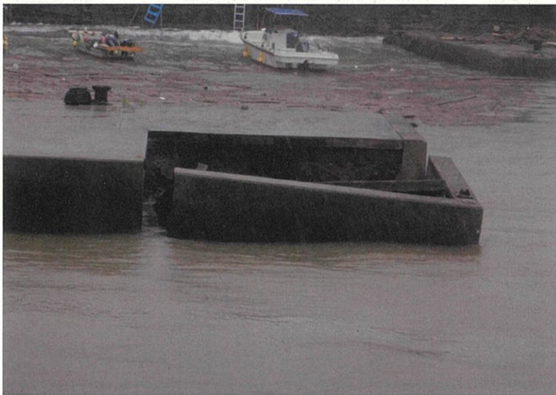
物揚場崩壊状況 （拡大）
