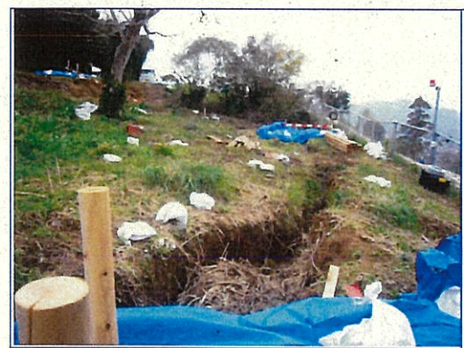
地盤クラック状況
