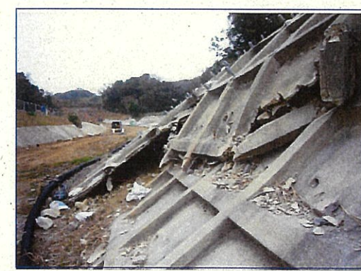
法枠コンクリートの押し出し状況
