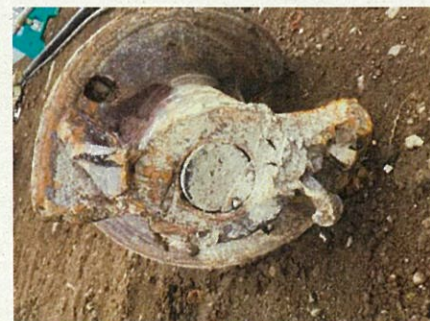
オーガー先端刃先 破損
