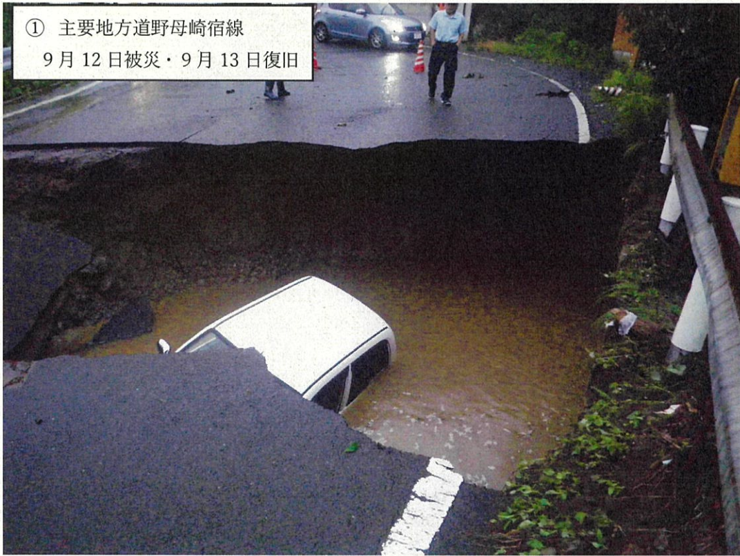
② 林道大崎線 9月12日被災・9月19日復旧
