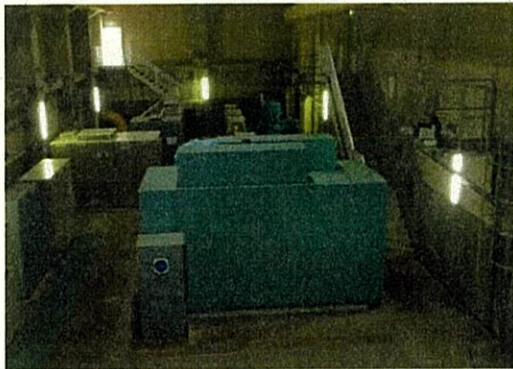
既設 No. 2 送風機状況写真
