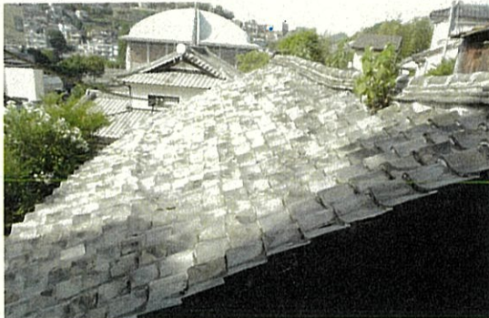
【H28 年 10 月】 屋根の全体的な波打ち（評点：50 点）
