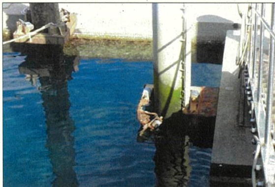
係留杭の腐食
