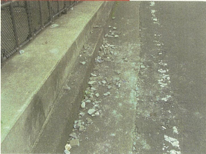
①②(西側道路)落下物
