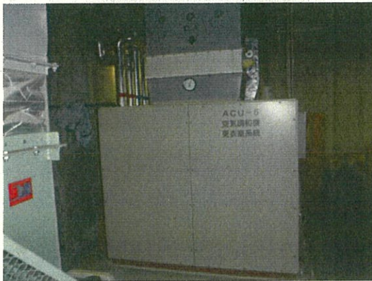
【男女更衣室用空調設備】
