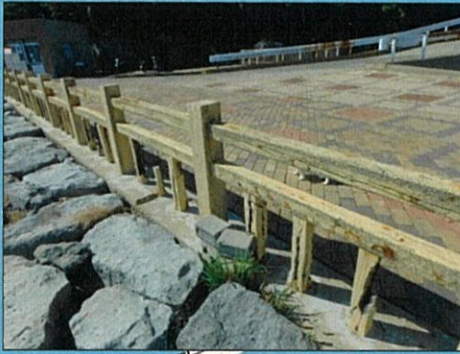
防護柵老朽化状況
