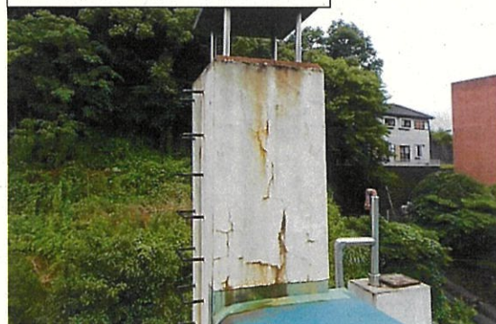
煙突壁モルタル亀裂・浮き
