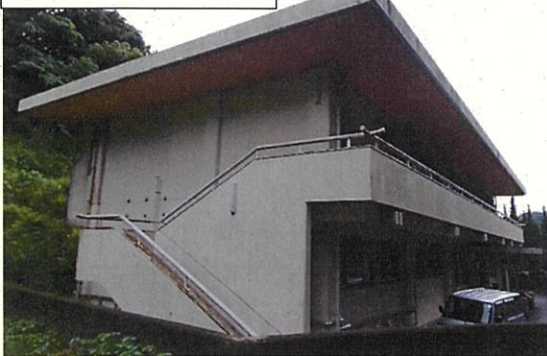
外壁モルタル浮き
