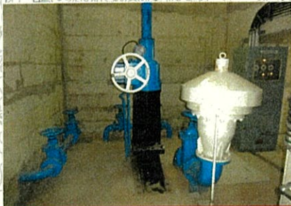
放流設備更新 スライドゲート φ600 昭和 50 年設置 45 年経過
