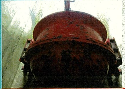
放流設備更新 ホロージェットバルブ φ600 昭和 50 年設置 45 年経過
