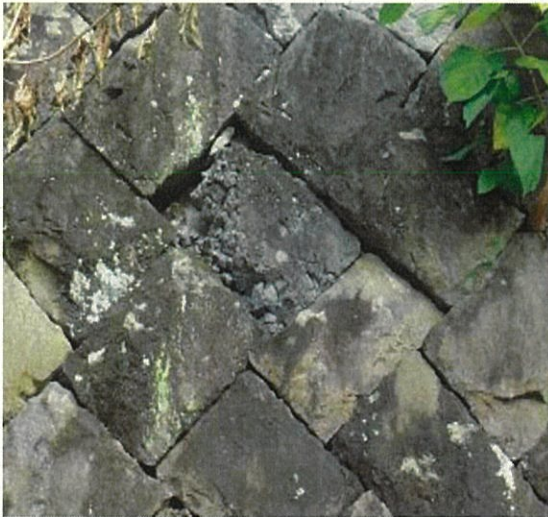
(城山小学校 石積み部分落下)
