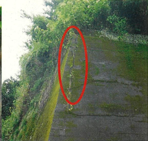
(西坂小学校 擁壁クラック)
