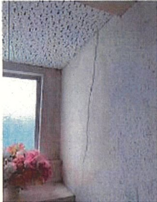
屋内 ひび 摩耗
