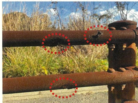
ガードパイプの孔食状況
