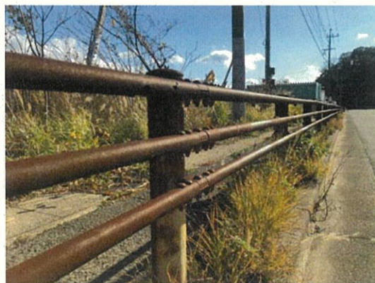
ガードパイプの発錆状況
