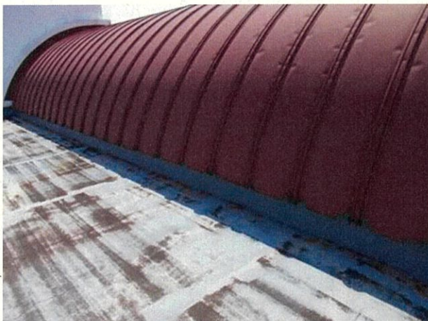
屋上（防水シート劣化）
