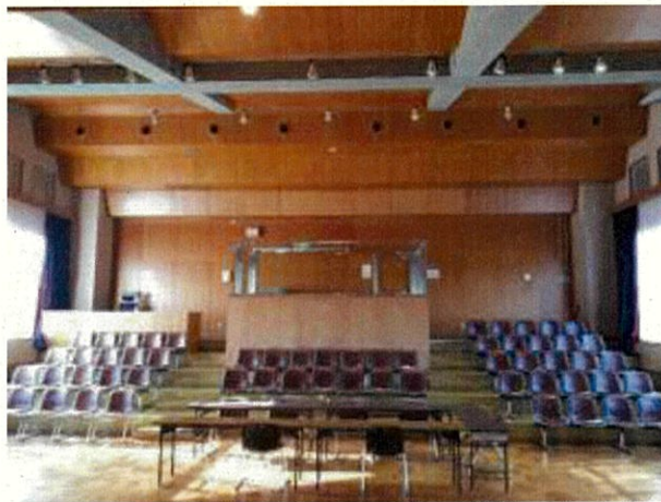
LED施工箇所例（ホール）
