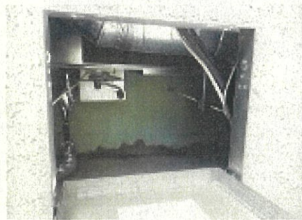
【室内ユニット（天井内）】
