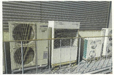
【室外ユニット】
