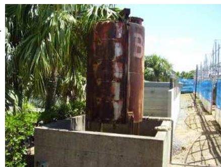
老朽化が著しい燃油タンク
