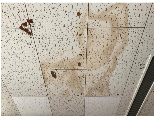
保育室の天井（雨漏り）
