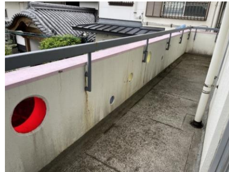
手すり・ベランダの劣化
