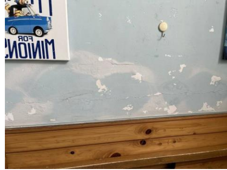
階段の壁（亀裂・塗装剥離）
