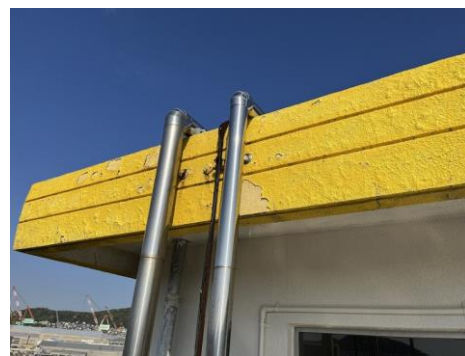
外壁（亀裂・塗装剥離）
