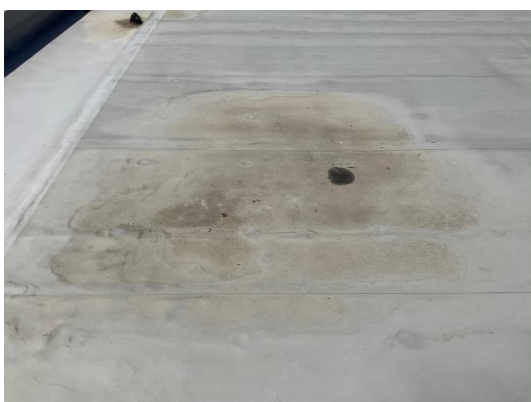
屋上（防水膜劣化）
