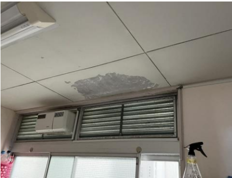
トイレの天井（剥離）
