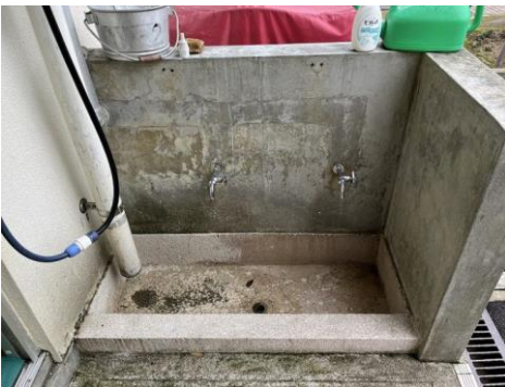
園児足洗場（亀裂・剥離・劣化）
