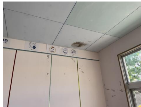
廊下の天井（雨漏り）
