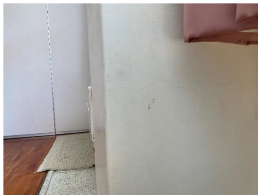
保育室の壁（亀裂）
