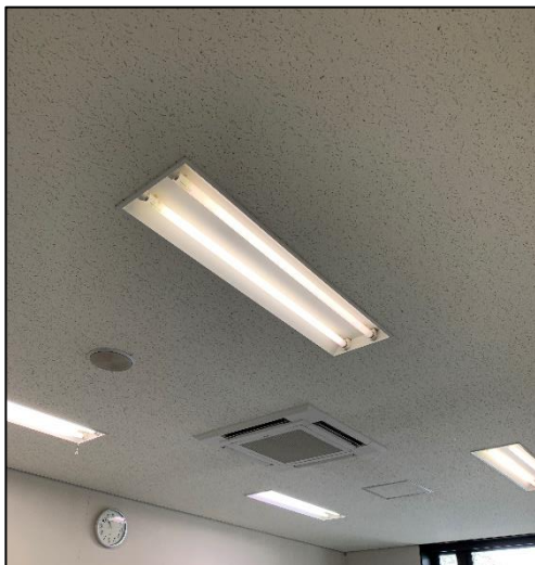
既設照明器具（蛍光灯）
