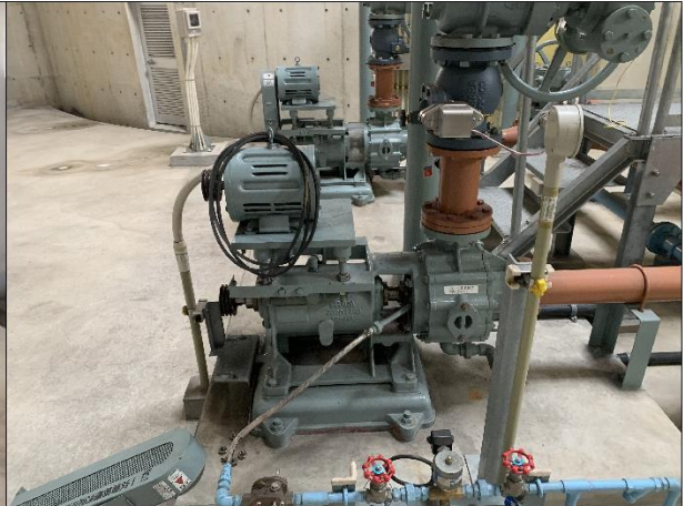
濃縮槽汚泥引抜ポンプ
