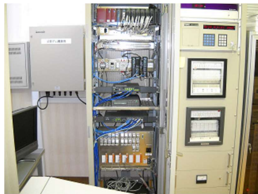
ダム監視装置(ダム管理事務所)
