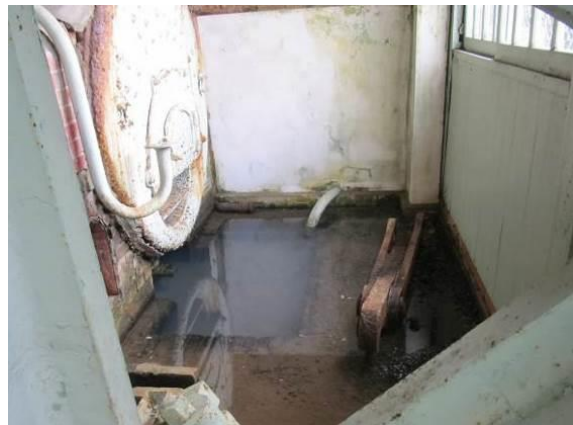
ボイラー前の滞水状況
