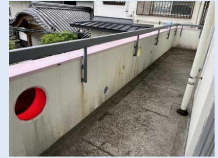
手すり・ベランダの劣化
