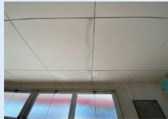
屋内天井(漏水跡)
