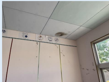
廊下の天井(雨漏り)
