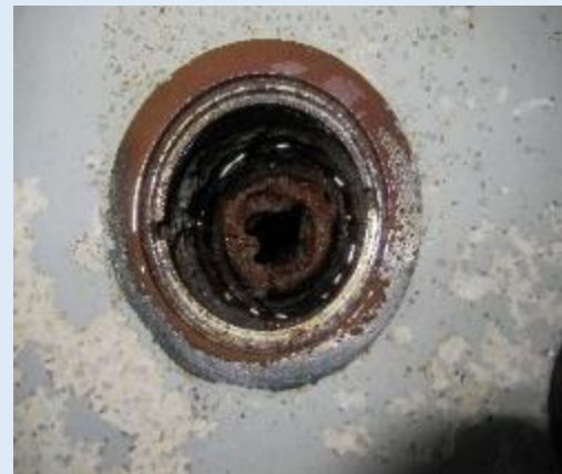
水道管(錆、詰まり)
