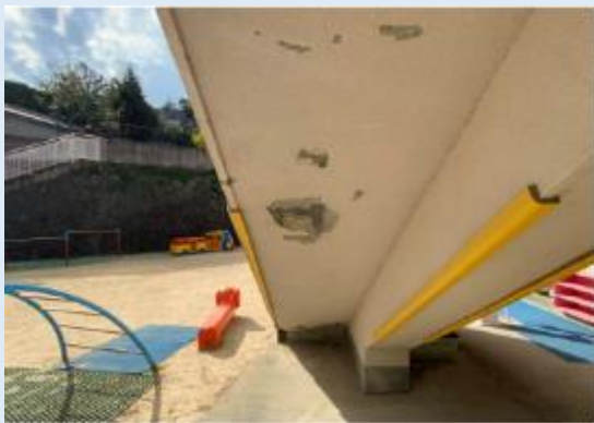
屋外軒裏(爆裂)
