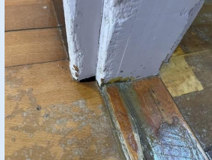
廊下の床(摩耗・亀裂)
