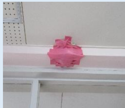
保育室の天井(雨漏り)
