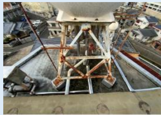
屋上水槽基礎(発錆)
