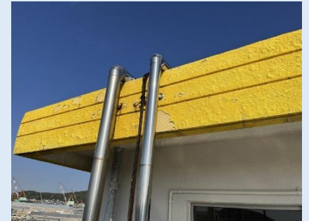
外壁(亀裂・塗装剥離)
