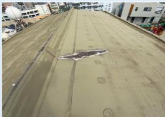
屋上防水(破断)
