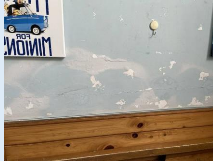
階段の壁(亀裂・塗装剥離)
