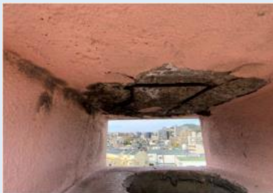
煙突躯体(爆裂)
