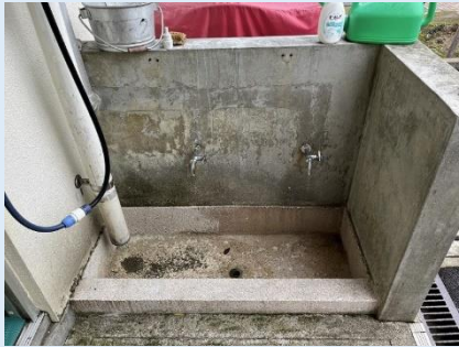
園児足洗場(亀裂・剥離・劣化)
