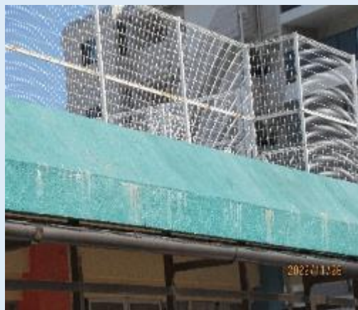
屋根部(剥離・劣化)
