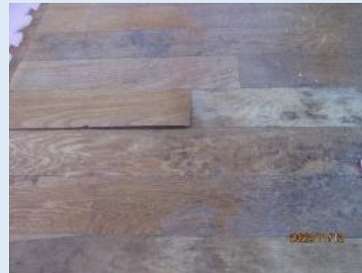
保育室床(剥離)
