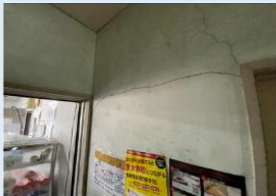
内壁(クラック)
