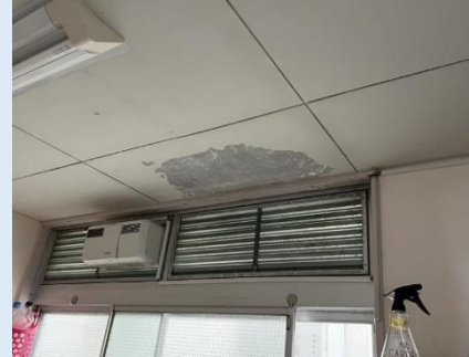
トイレの天井(剥離)
