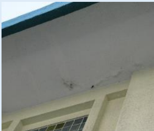
外壁(亀裂・塗装剥離)
