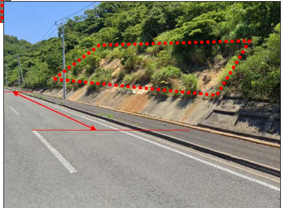
道路改良箇所の現況(法面植生基材の流出)
