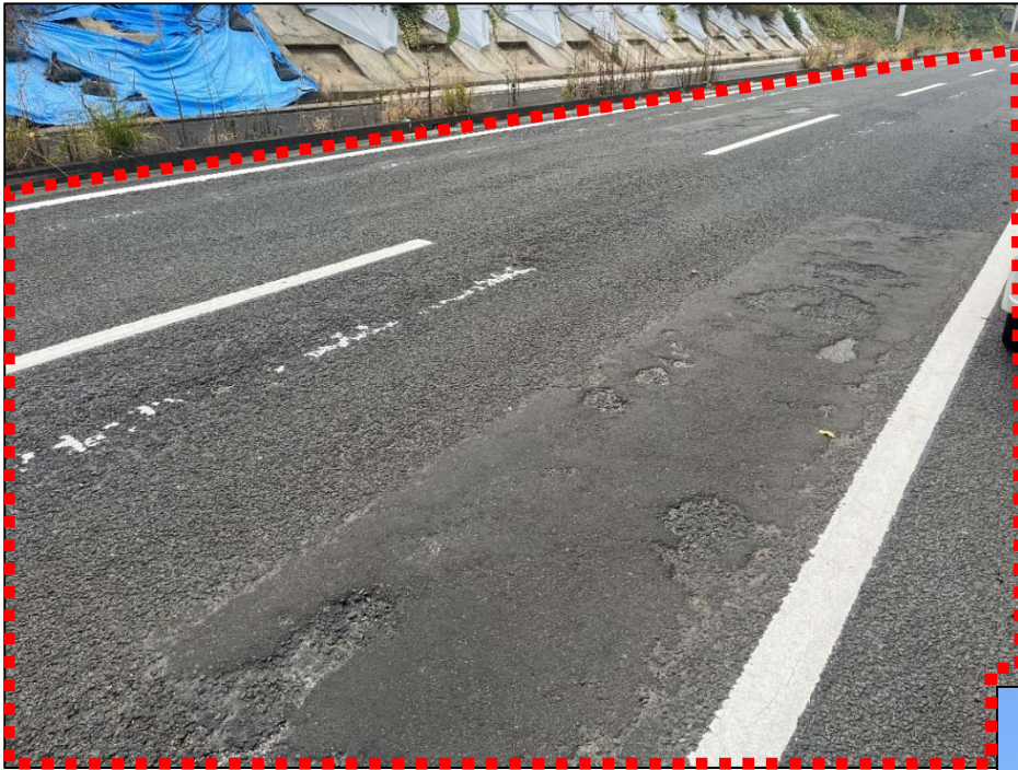
道路改良箇所の現況(舗装のひび割れ)
