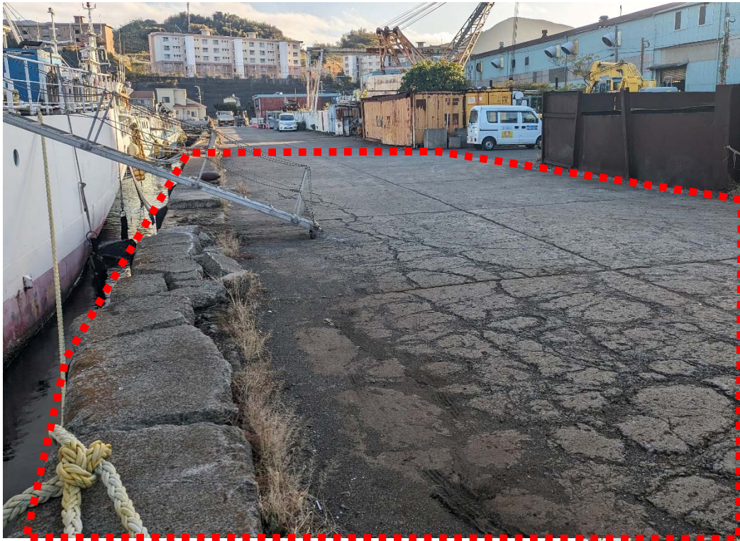
岸壁改良箇所の現況(舗装のひび割れ)
