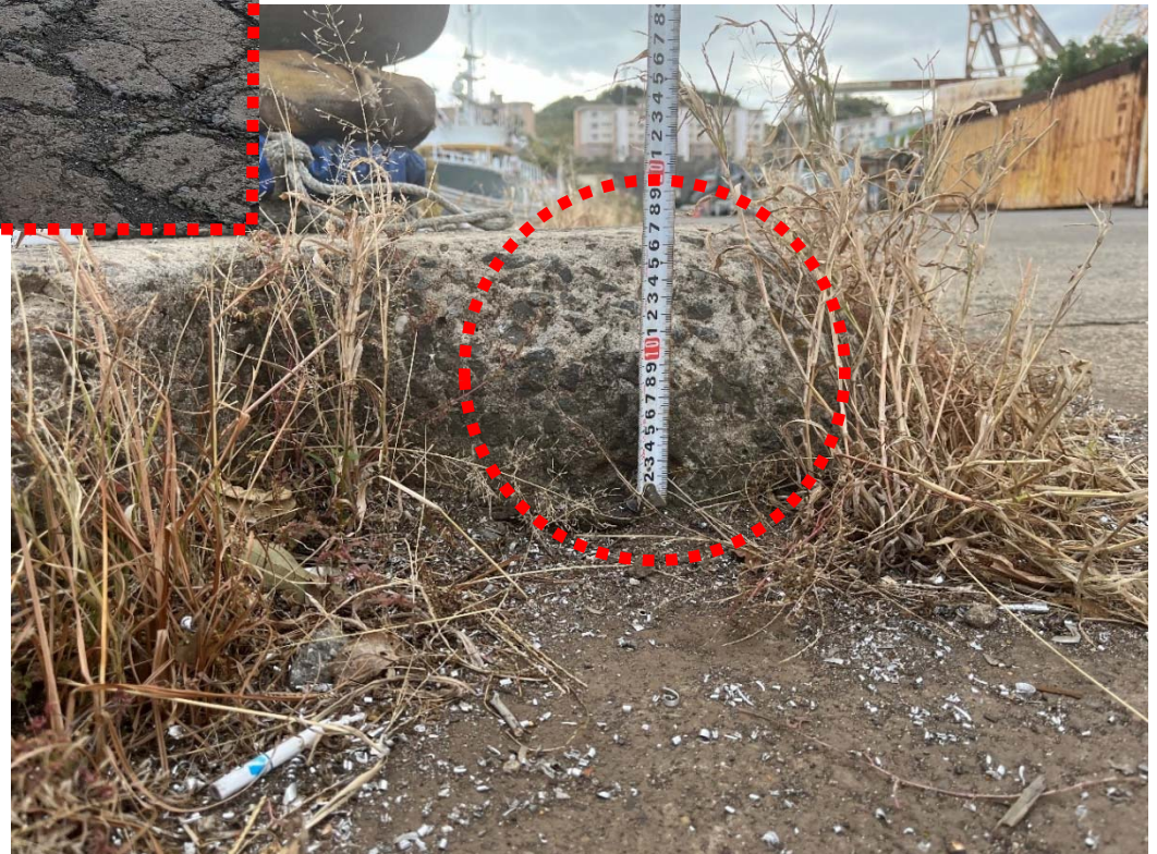
岸壁改良箇所の現況(岸壁の沈下)
