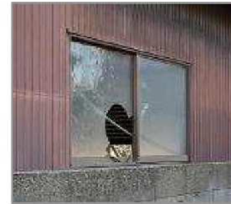
窓が割れた管理不全空家
