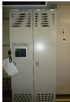
放流警報設備
