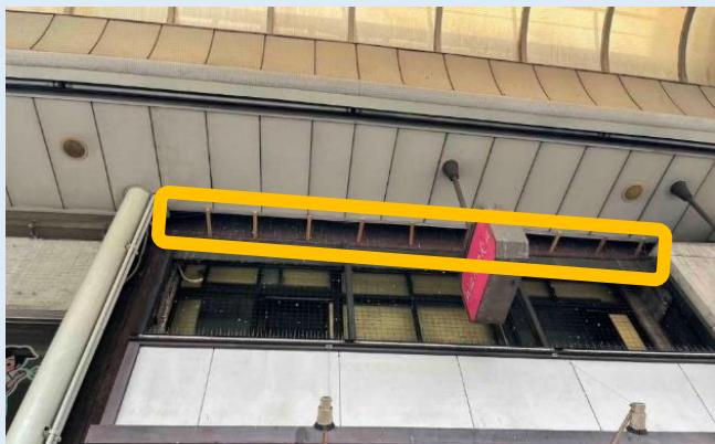
▲鳩が隙間から侵入している
