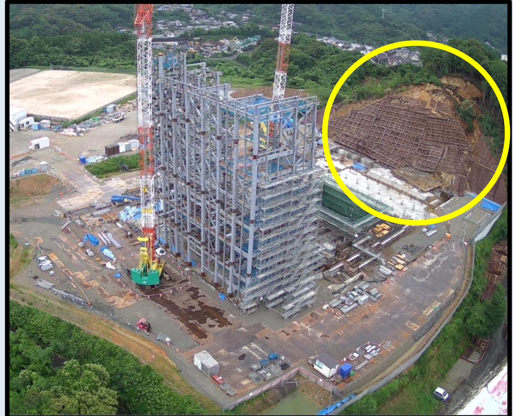
イ 法面崩落后（令和6年6月10日時点）
