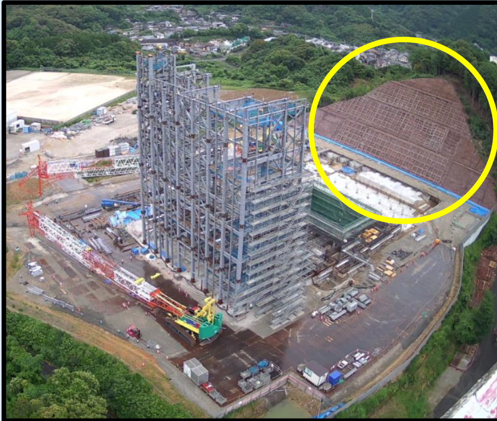
ア 法面崩落前（令和6年6月8日時点）
