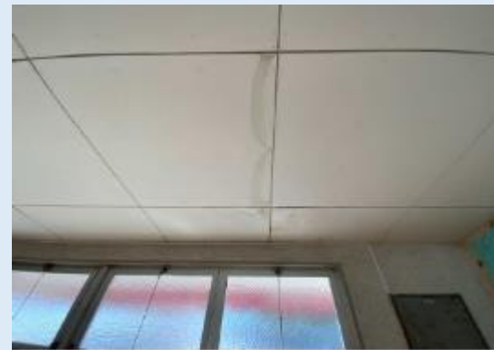
屋内天井(漏水跡)
