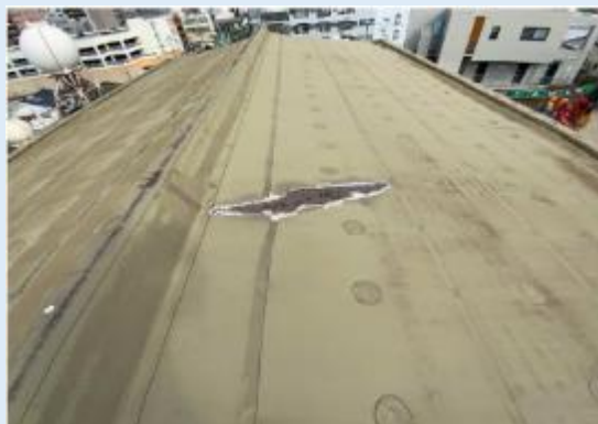
屋上防水(破断)
