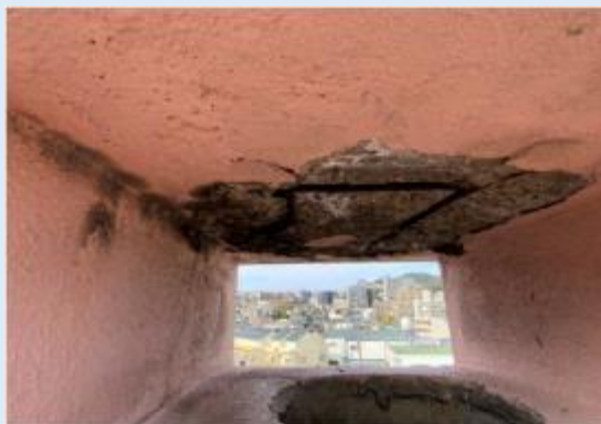
煙突躯体(爆裂)
