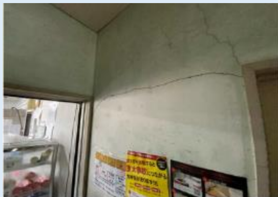
内壁(クラック)
