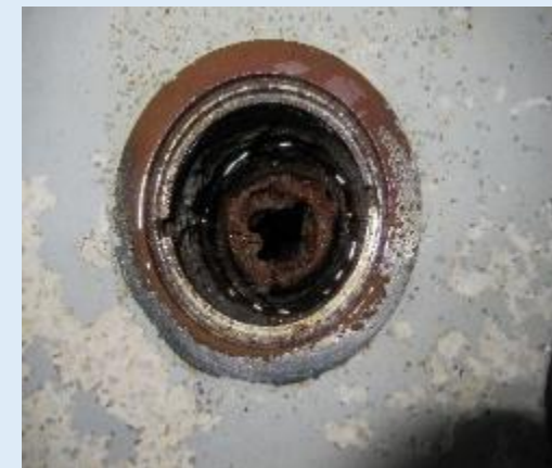
水道管(錆、詰まり)
