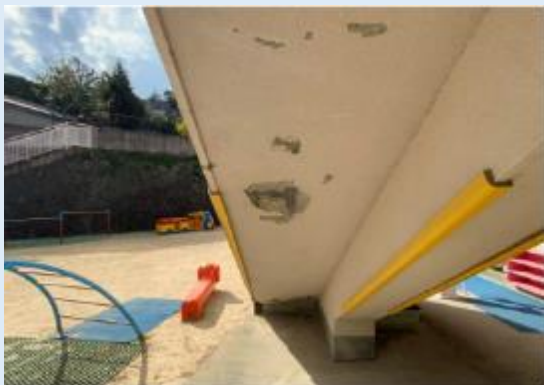
屋外階段裏(爆裂)
