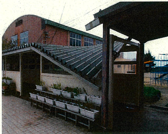
(南小学校 渡り廊下 屋根落下)
