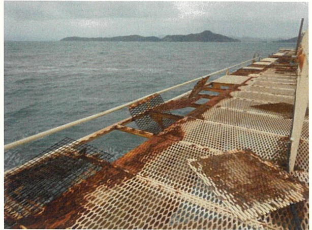
(b) 釣台床 被災状況
