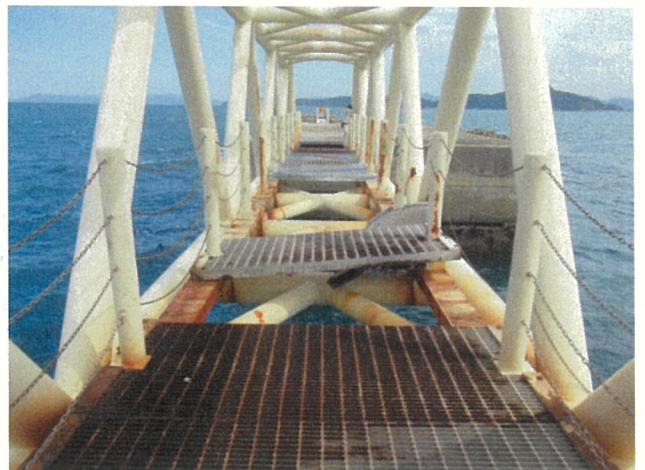
(b) 釣台床 被災状況
