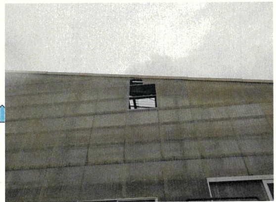
魚類生産棟外壁 2 枚損傷
