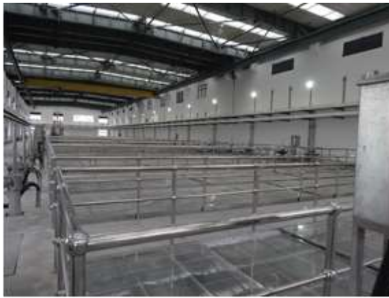
建屋内のMBR設備
