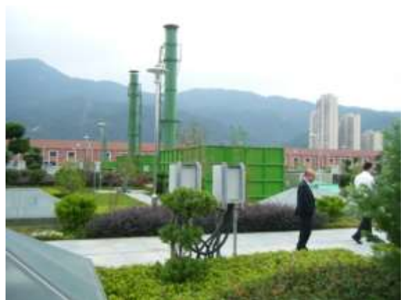
臭気対策として生物脱臭装置を設置
