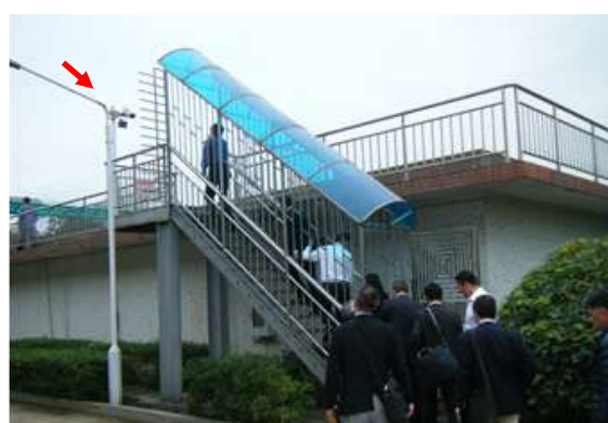
要所要所に侵入監視用のカメラを設置 (360°監視可能なカメラもあり)
