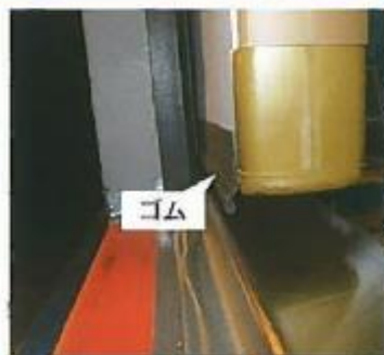
②戸下部に設置した気密ゴム
