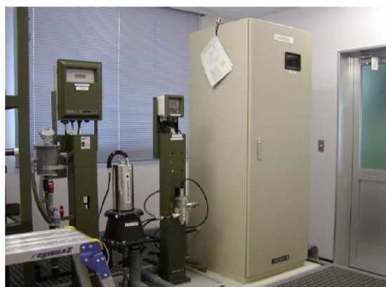
油分計（臭気センサー） 紫外線吸光度計（有機物） 電気伝導度計（無機物）
