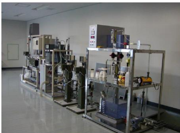
魚類監視装置（浄水）
